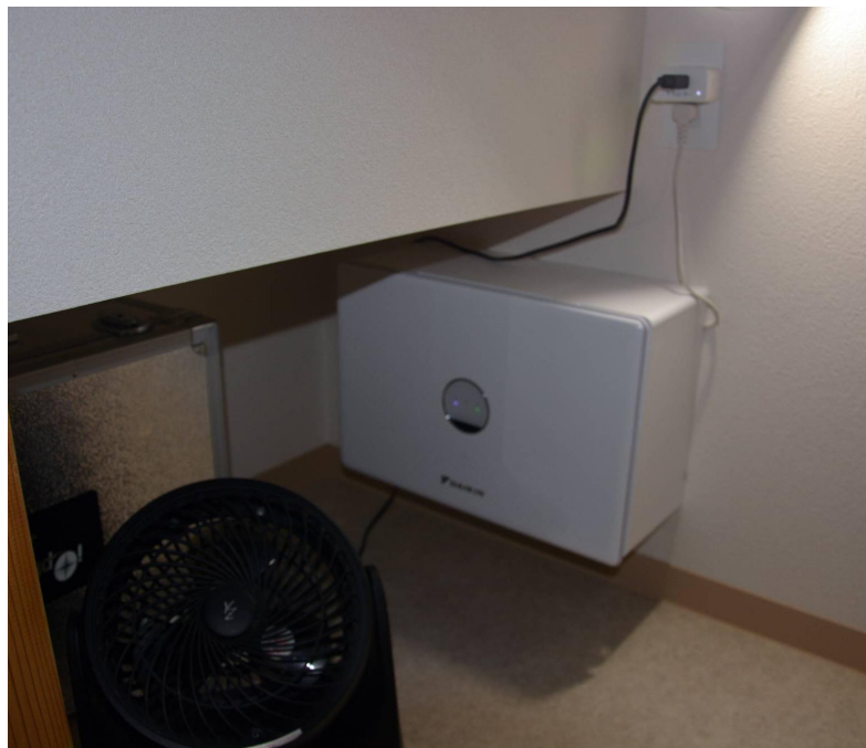
カライエ 常時稼働除湿器設置状況
